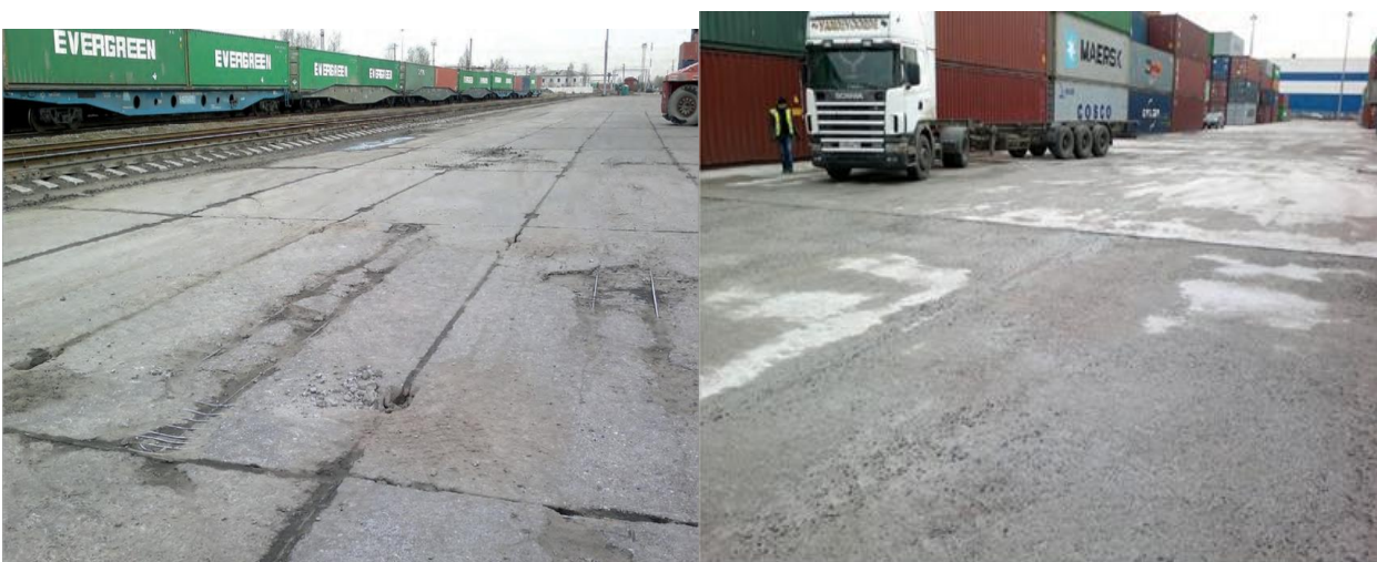
Рисунок 3 – Руйнування покриття зі збірних залізобетонних плит та лущення монолітних залізобетонних покриттів
