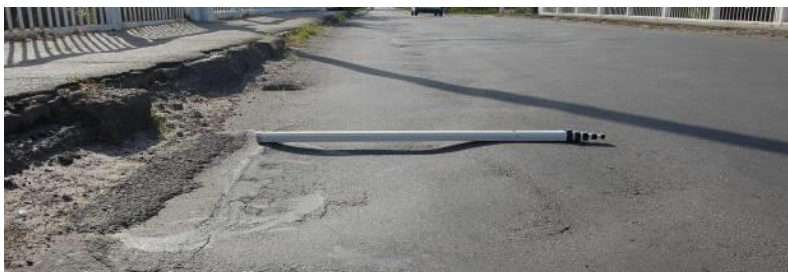
Рисунок 4 – Колійність на проїзній частині мосту (м. Чугуїв)
