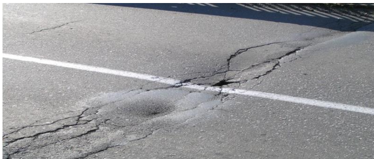
Рисунок 3 – Руйнування шарів дорожнього одягу в зоні деформаційного шву на сполученні з перехідною плитою (міст через р. Сів. Донець в сел. Ст. Салтів)
