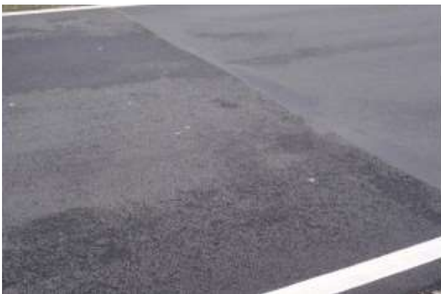
Рисунок 2 – Початок розтріскування тонкого поверхневого шару Figure 2 – Beginning of cracking of the thin surface layer
