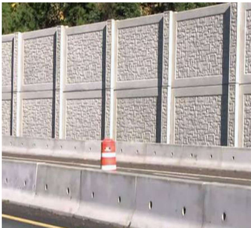
Рисунок 5 – Бетонний шумозахисний екран
