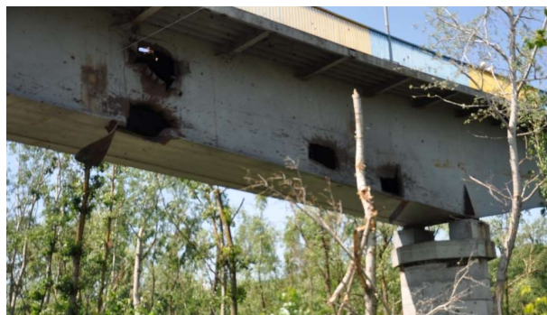
Рисунок 11 – Руйнування снарядами балки мосту
