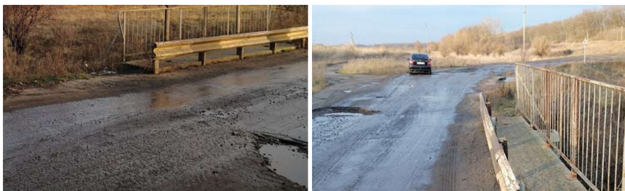
Рисунок 5 – Характерні дефекти дорожнього покриття мостів в зоні деформаційних швів
