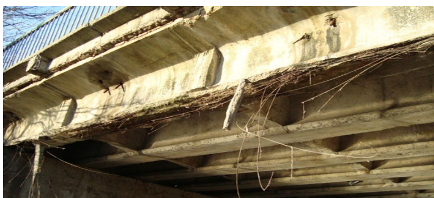
Рисунок 6 — Обрив струн балки Figure 6 — Breakage of the beam strings
