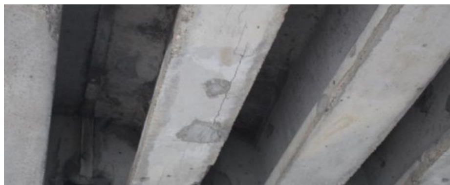
Рисунок 2 — Тріщини на нижній грані балки прогонової будови, утворені внаслідок корозії арматури Figure 2 — Cracks on the lower face of a girder beam in a span structure caused by corrosion of reinforcement
