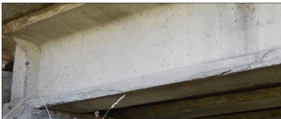
Рисунок 1 — Силлові тріщини в тілі балки прогонової будови Figure 1 — Force cracks in the beam body of a span structure
