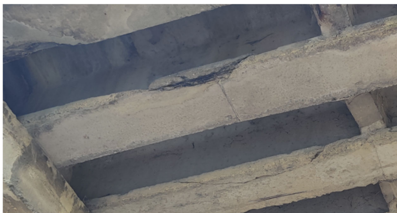
Рисунок 5 — Характерні відколи бетону утворені внаслідок розриву струн Figure 5 — Characteristic concrete spalling caused by string breakage
