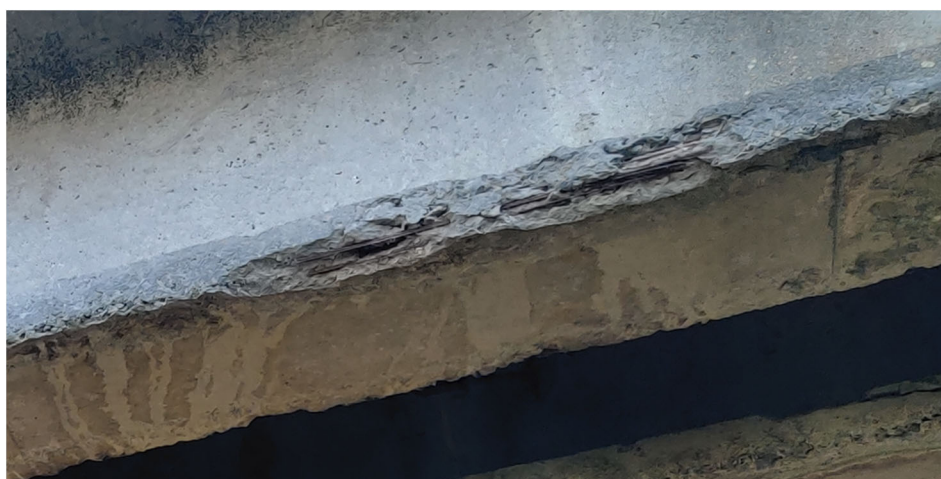
Рисунок 3 — Руйнування захисного шару бетону із оголенням та корозією струн Figure 3 — Failure of the concrete protective layer with exposure and corrosion of the strings
