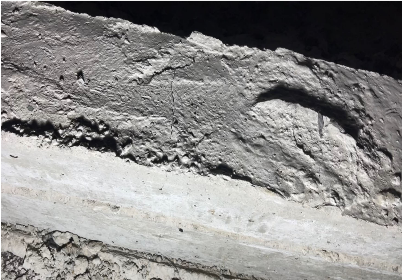
Рисунок 2 – Тріщина в залізобетоні зовнішнього канату підсилення праворуч у прогоні 7-8 на відстані 2 м від опори 7 з розкриттям до 1,5 мм
