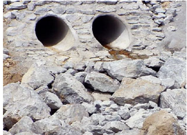
нераціональне розміщення кам'яної насипки
