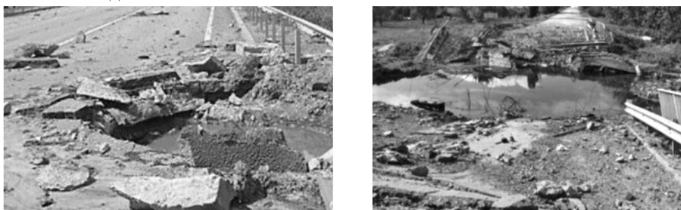
Рисунок 1 – Найбільш часті пошкодження доріг при військових діях Figure 1 – Most frequent road damage during military operations
