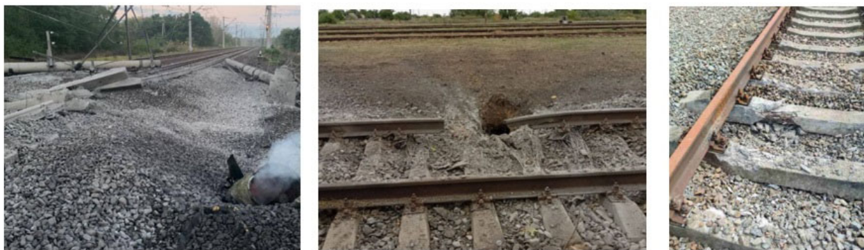
Рисунок 7 – Виявлені за допомогою БПЛА пошкодження на досліджуваній ділянці Figure 7 - Damage detected by UAVs in the study area
