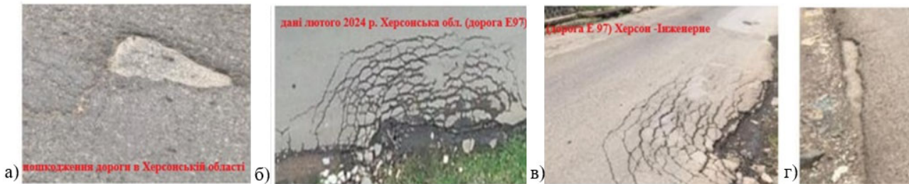
Рисунок 4 – Виявлені в результаті військових дій пошкодження на дорозі E 97 (а) – вибоїна на дорозі, б), в) г) – пошкодження краю дороги)
