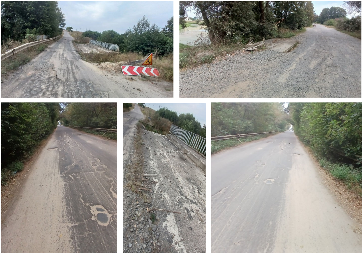
Рисунок 2 – Ділянки незавершених ремонтів мостових споруд на дорозі Т-18-17 Figure 2 – Unfinished repair sites of bridge structures on the highway T-18-17
