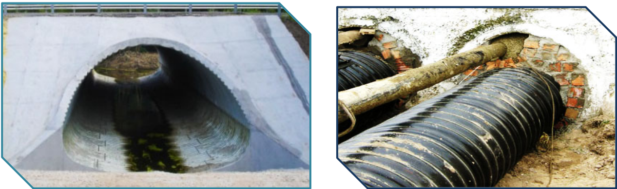
Рисунок 1 – Підсилені пошкоджені споруди методом гільзування із використанням металевих гофрованих конструкцій та труб
