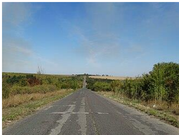
Рисунок 1 – М-13 Стан покриття Figure 1 – M-13 Pavement Condition
