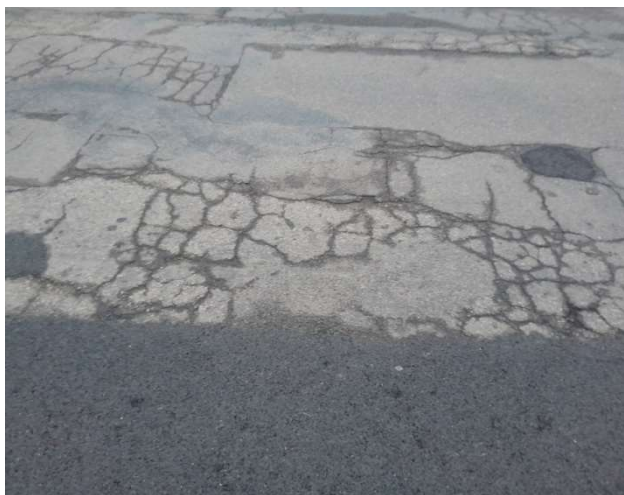
а) вигляд стику між стрим покритвом та новим шаром холодного асфальтобетону
