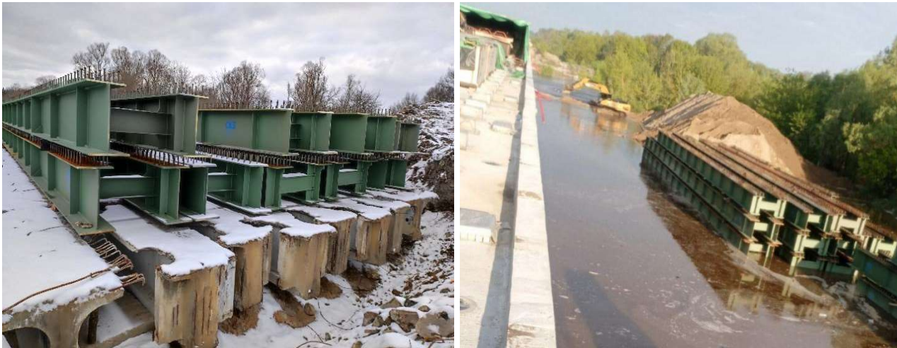
Рисунок 9 – Зберігання нової прогонової будови на демонтованих балках. Figure 9 – Storage of the new span structure on dismantled beams
