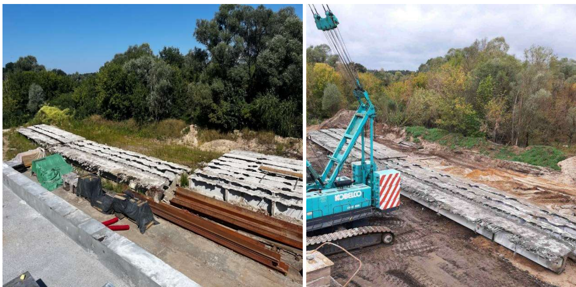
Рисунок 8 – Демонтаж та складання залізобетонних балок на будмайданчику. Figure 8 – Dismantling and assembly of reinforced concrete beams at the construction site.
