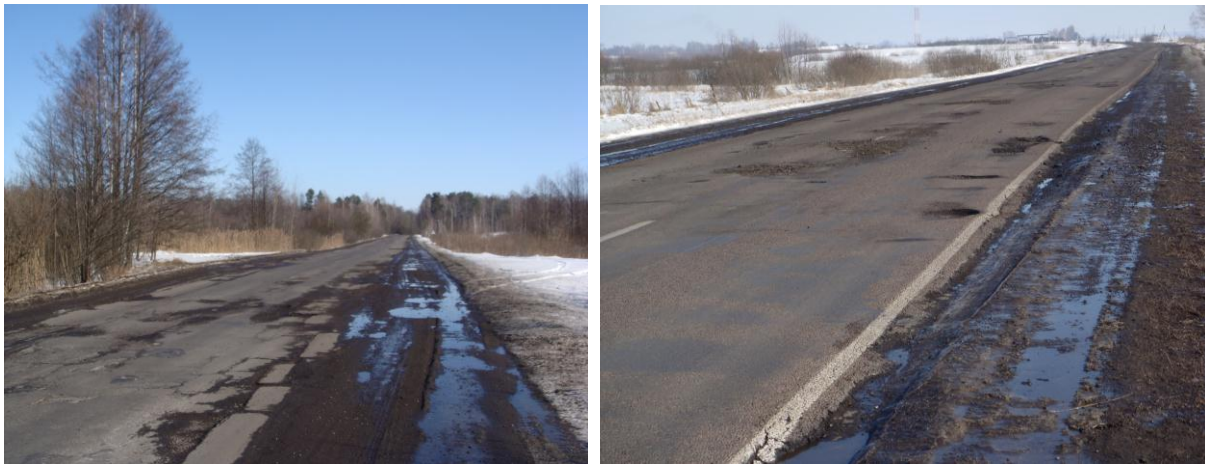
Рис. 2. Місця проникнення води через покриття
