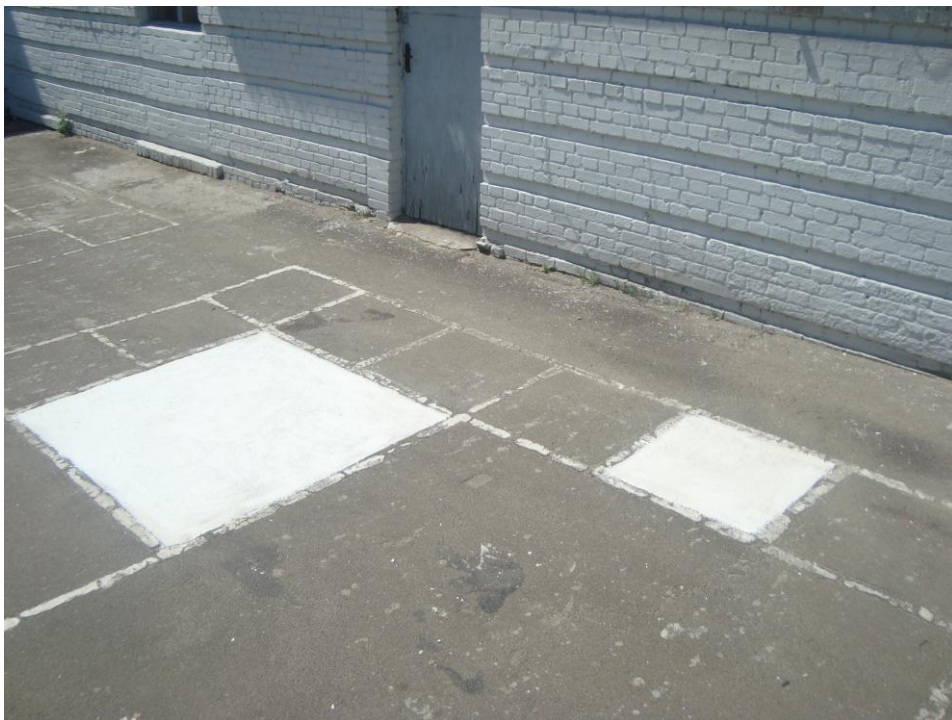
Рис. 6. Зафарбовані ділянки асфальтобетонного покриття
