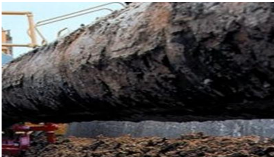
Рис. 1. Стан зовнішньої стінки трубопроводу, який пролежав в ґрунті 30...40 років
