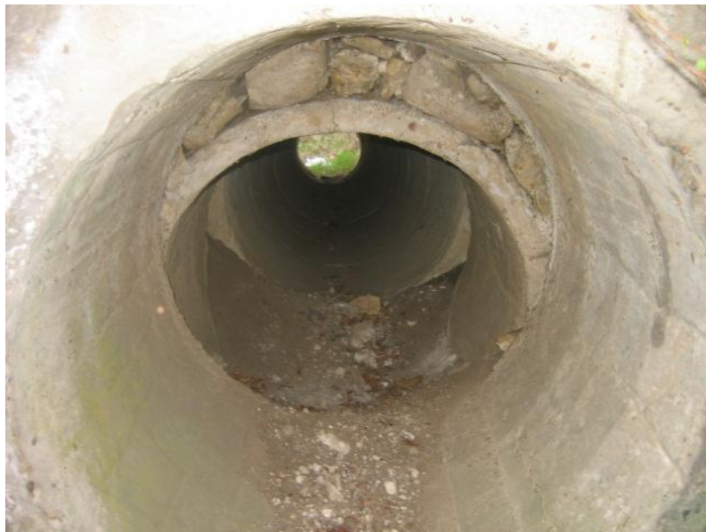
Рис. 3 Просідання кільця в тілі труби
