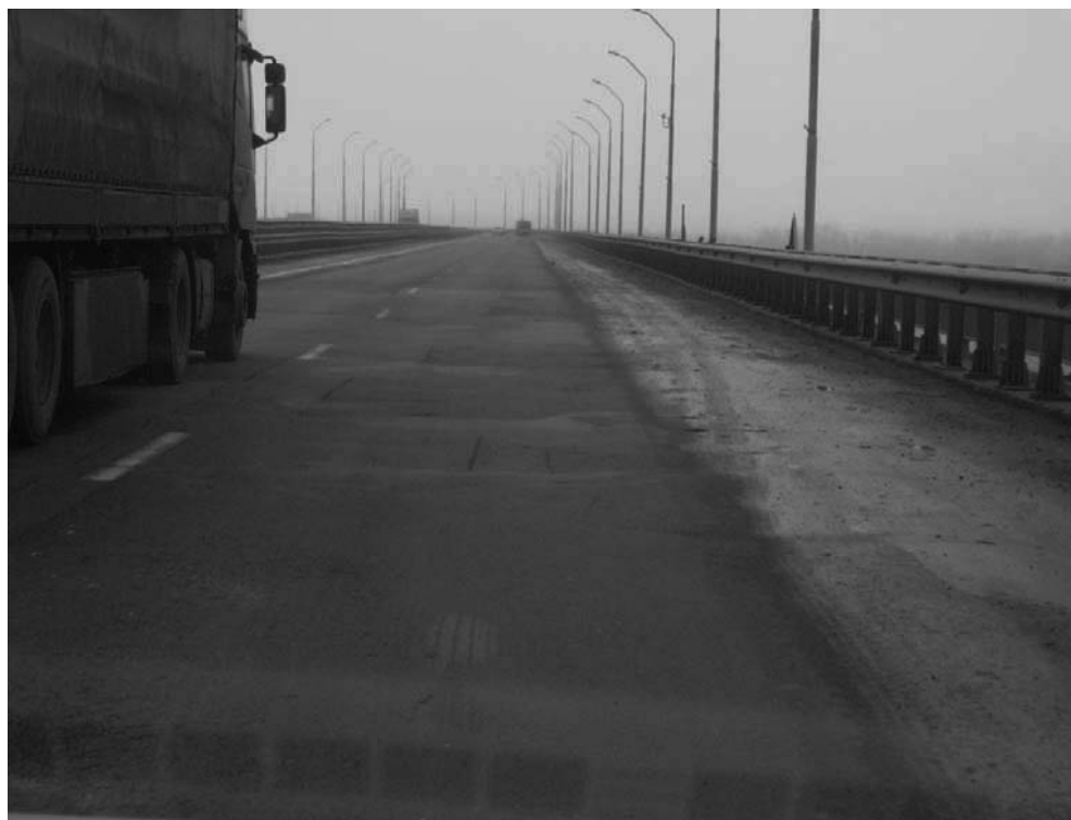
Рис.2. Образование неровностей на проезжей части сталебетонного моста при использовании рулонной гидроизоляции «Мосто-пласт»
