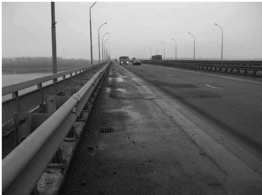
Рис. 3. Образование вмятин и пузырей на проезжей части моста
