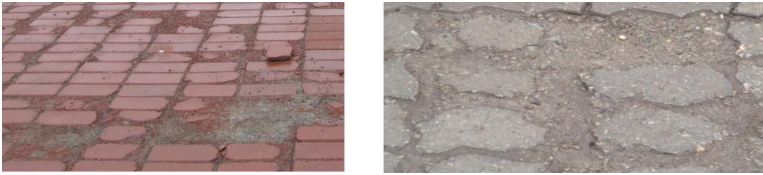
Рисунок 3 – Руйнування, що спровоковане незадовільною морозостійкістю бетонних елементів бруківання (розкришування)
