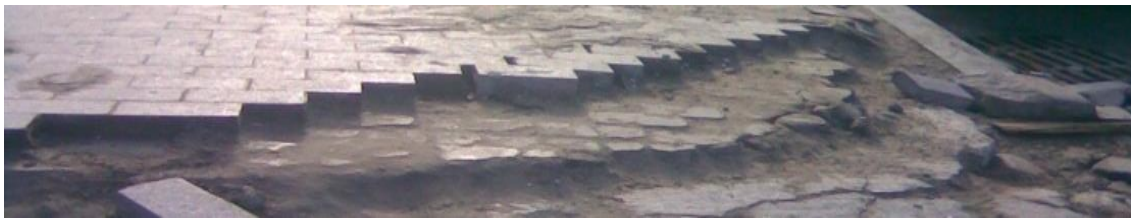
Рисунок 8 – Руйнування покриття, що викликане відсутністю бокового упору для каменів брукування
