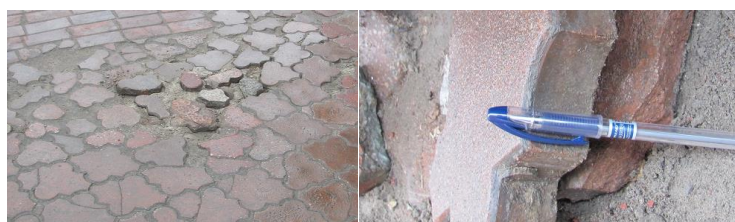
Рисунок 1 – Руйнування, що спровоковані малою товщиною елементів мощення
