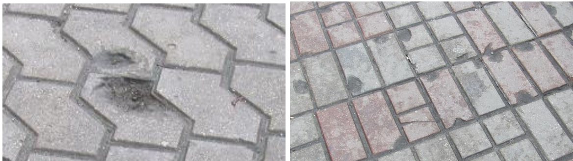
Рисунок 5 – Відколювання частин бетону з утворенням раковин
