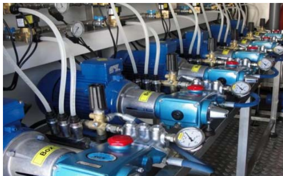
Rys.10. System pompowy myjni [11]
